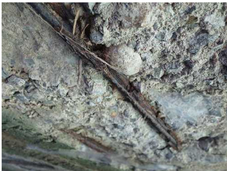
velmi silná koroze uložené betonářské výztuže
