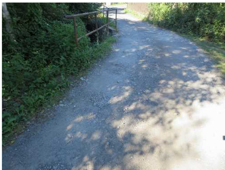
stávající stav krytu vozovky
