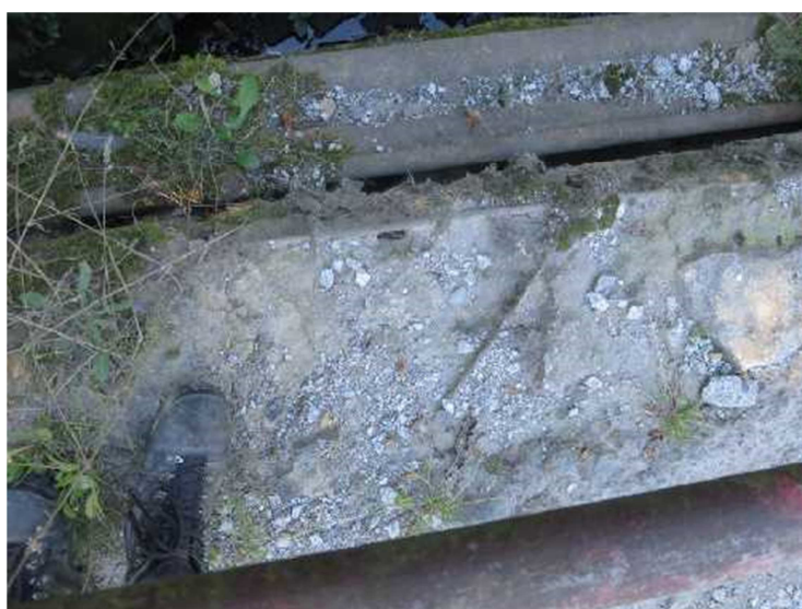
degradace betonu římsy
