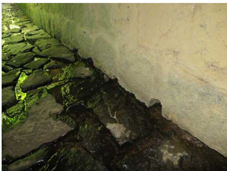
zdivo díku opěry je částečně podemleté v úrovni kolísání hladiny potoka
