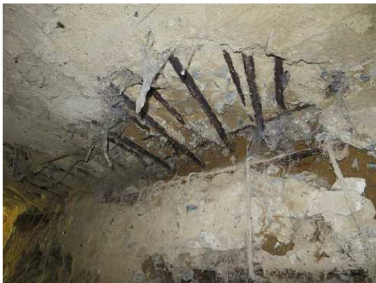
hloubková degradace betonu desky
