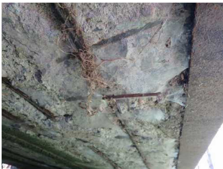
hloubková degradace betonu desky mostovky
