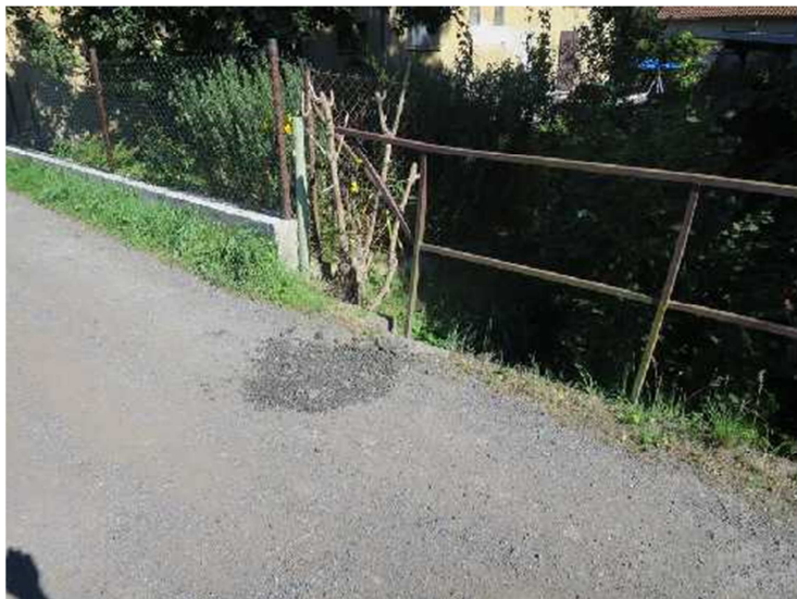
kryt vozovky je udržován dle možností správce komunikace
