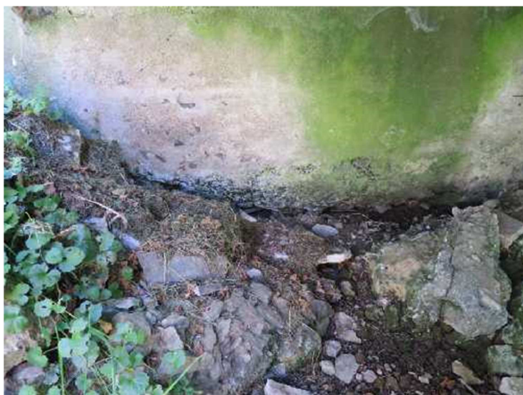
otevřená spára mezi dřikem opěry a terénem.
