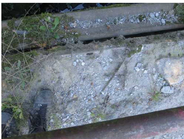
degradace betonu římsy
