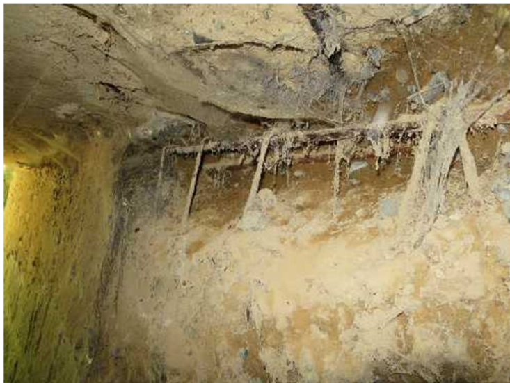
hloubková degradace betonu koncového příčnicku
