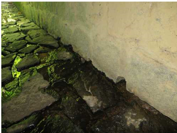
zdivo dříku opěry je částečně podemleté v úrovni kolísání hladiny potoka
