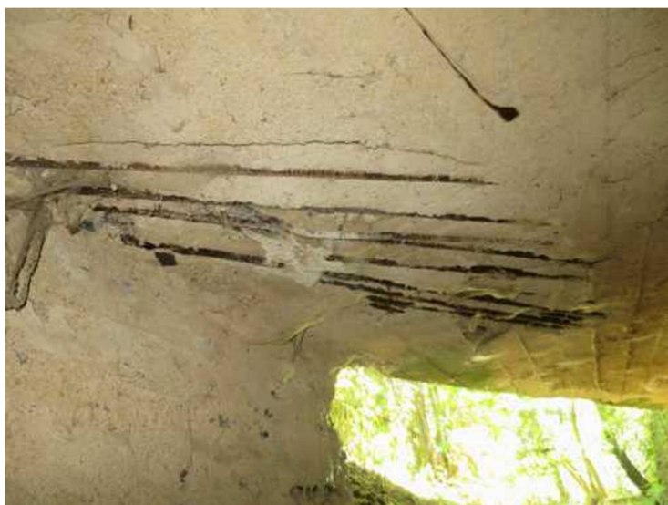
výrazná koroze obnažené výztuže desky mostovky
