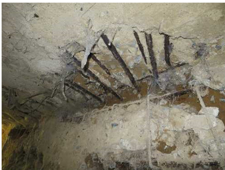
hloubková degradace betonu desky
