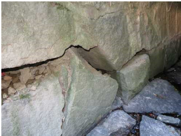
hloubkové vyplavení spárové malty ze zdiva dřívku opěry
