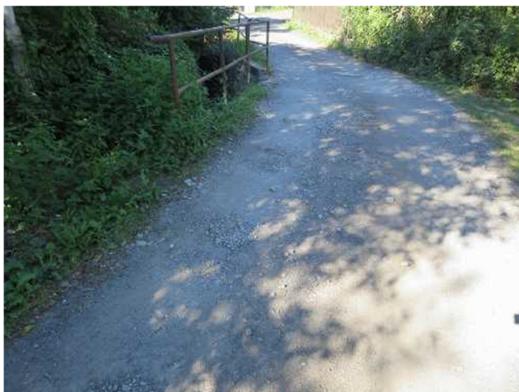
stávající stav krytu vozovky
