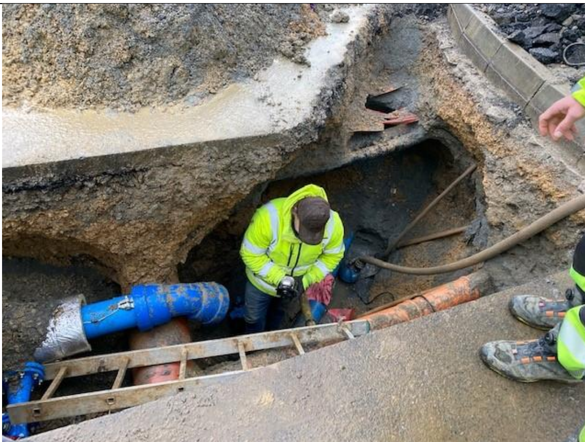
Foto /42/ Místo řešené opravy V5: Zásah do vodovodu v ul. Pod Vápenkou (snímek pořízen 10. 1. 2022). Nezapažený výkop – hrubé porušení předpisů a BOZP.
