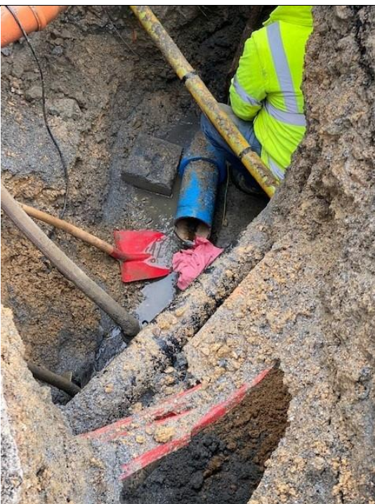
Foto /43/ Místo řešené opravy V5: Zásah do vodovodu v ul. Pod Vápenkou (snímek pořízen 10. 1. 2022). Znečištěné potrubí, kontaminace.
