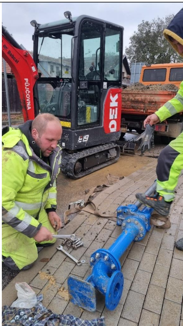
Foto /24/ Místo řešené poruchy V4: Zásah do vodovodu v ul. Pod Vápenkou (snímek pořízen 14. 10. 2021). Na snímku je vidět demontovaný hydrant. Dle sdělení zadavatele bylo příčinou netěsnosti nedotažení spojů. Pozn. Znalce: Na snímku prováděné montážní práce byly provedeny s největší pravděpodobností bez použití momentového klíče a v rozporu s technickými požadavky výrobce potrubí.
