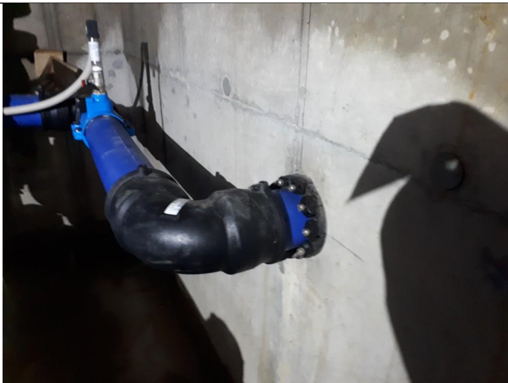
Foto /48/ Umístění snímače tlaku je v rozporu s PD (snímek pořízen 25. 1. 2022).
