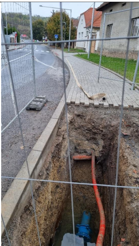
Foto /25/ Místo řešené poruchy V2: Zásah do vodovodu v ul. Psárská u č.p. 10 (snímek pořízen 14. 10. 2021. Nezajištěný výkop, kontaminace vodovodu.
