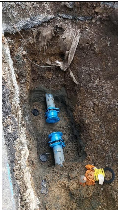
Foto /5/ Místo řešené porucha V8 : Zásah do vodovodu před budovou OÚ Psáry (snímek pořízen 4. 8. 2021). Na snímku je vidět rozpojené potrubí vodovodu.
