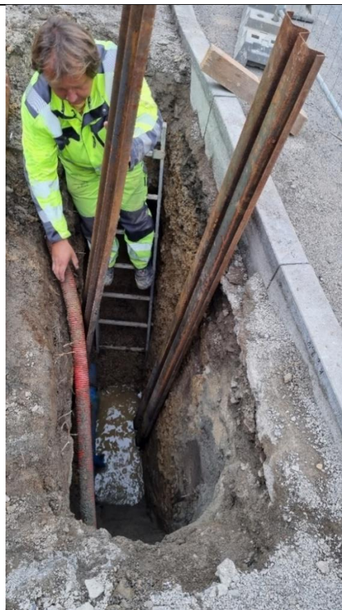
Foto /20/ Místo řešené poruchy V2: Zásah do vodovodu u domu č.p. 10 v ul. Psárská (snímek pořízen 4. 10. 2021), nedostatečně zajištěný výkop.
