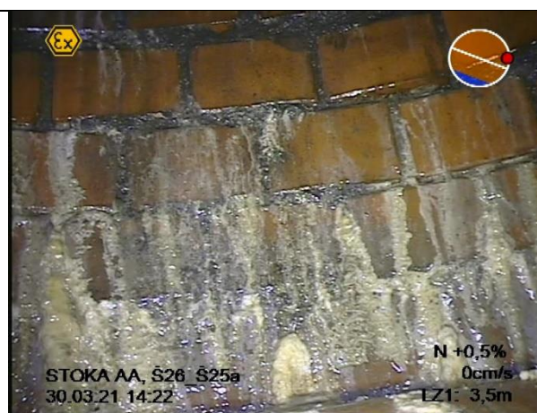
Foto /52/ Tvorba inkrustací na vnitřní stěně šachty ŠAA-25A [86]
