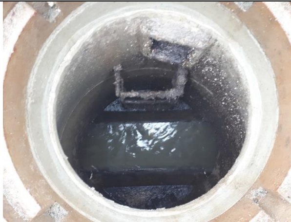
Foto /53/ Nečistoty na stěně a na stupadlech v šachtě ŠAA-03 (vlevo) [108]
