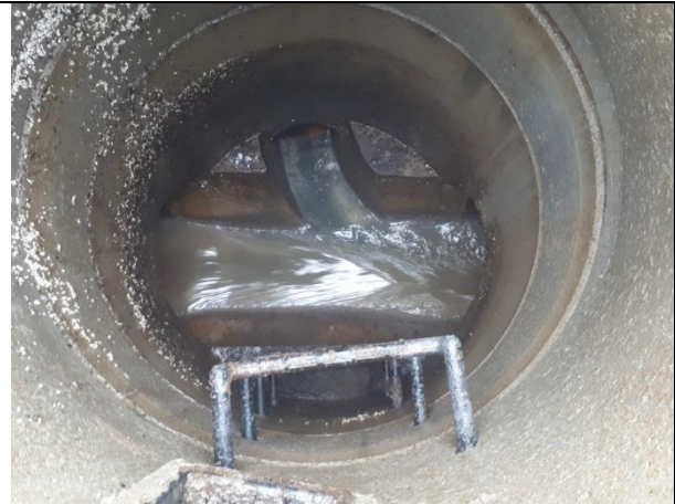
Foto /54/ Nečistoty na stěně v šachtě ŠAA-04 (vpravo) [108]
