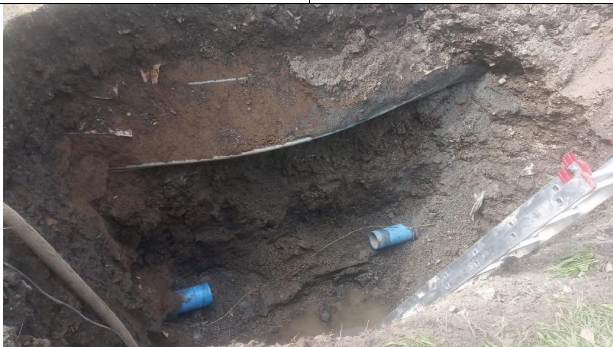
Foto /10/ Místo řešené poruchy V6: Zásah do vodovodu v ul. Psárská u č.p. 5 (snímek pořízen 10. 8. 2021). Na snímku je patrné rozpojené potrubí, nezajištěný výkop a odhalování sítě TI souběžných s vodovodem.
