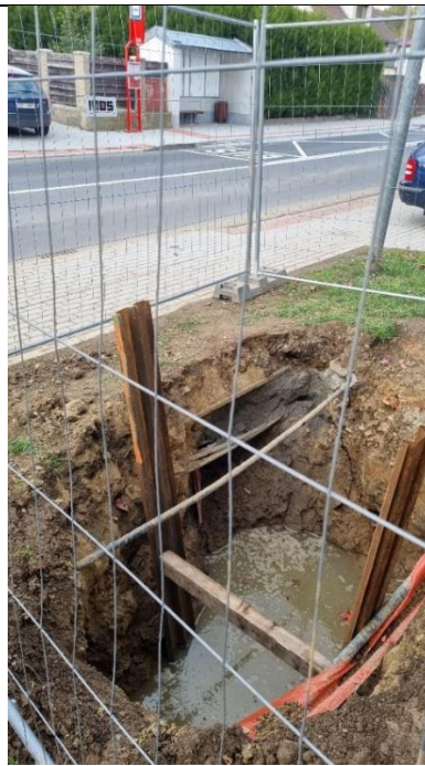
Foto /34/ Místo řešené opravy V3: Zásah do vodovodu v ul. Psárská u č.p. 8 (snímek pořízen 16. 10. 2021). Zaplavení výkopu kontaminovaného vodovodu.
